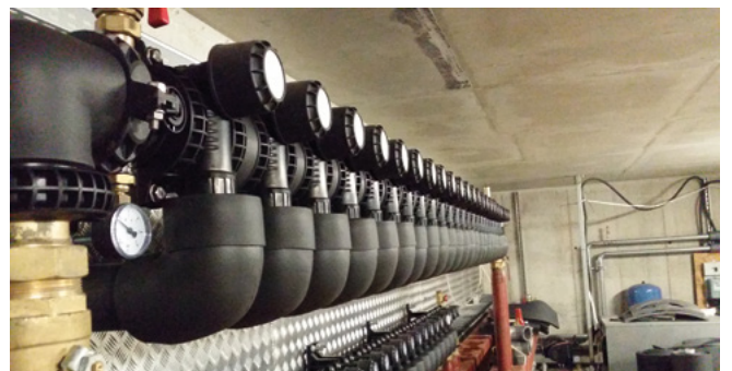
Фотография показывает коллектор ProCalida GT3 27-контурный в системе грунтового теплообменника теплового насоса. Система находится в торговом центре Huta в местечке Węgierska Górkа (Южная Польша).
